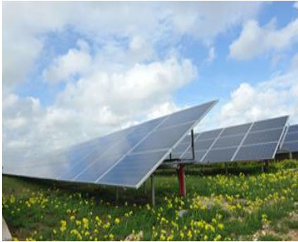
Imm. 1: il fotovoltaico
